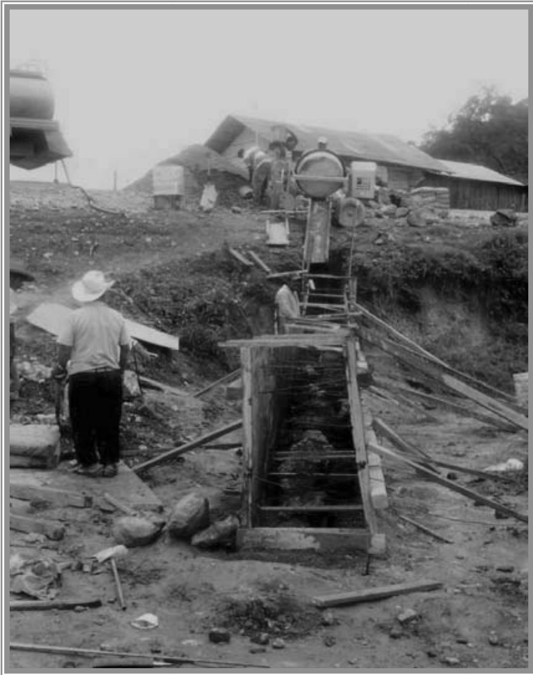
Realizando obra de drenaje en la calle principal de San Andrés Cabecera Nueva.
