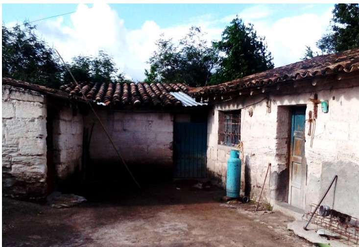
Figura 32. Vivienda de piedra deteriorada.
