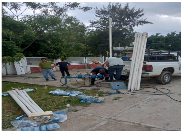
Figura 46. Tanque y bomba de agua potable en San Dionisio Ocotlán
