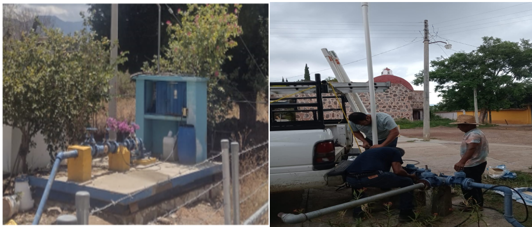
Figura 36. Bombas de agua potable en San Dionisio Ocotlán
