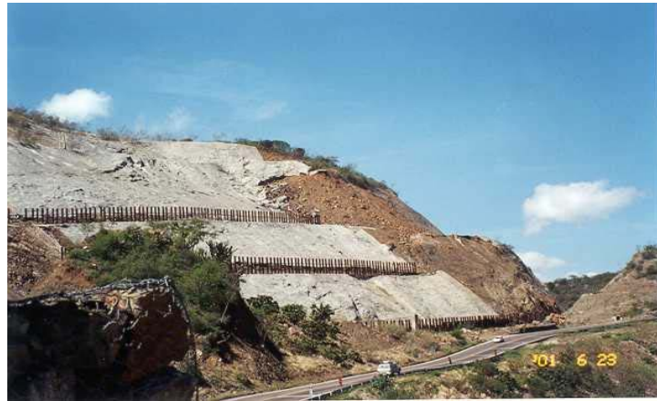
Fotografía No. 24.- Detalle de erosión antropogénica por obras civiles sobre zonas de falla, fotografía tomada en el Km 96.2 de la supercarretera Oaxaca-Cuacnopalan, en la zona del tunel que nunca funcionó.
