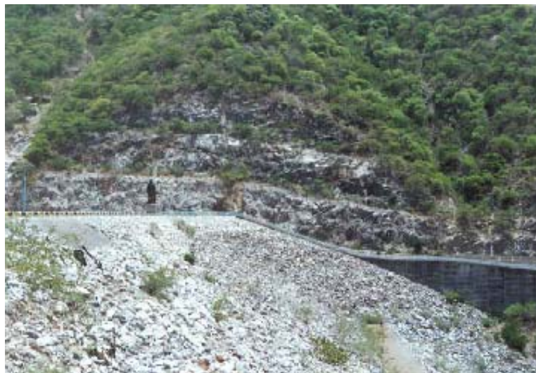
Fotografías Nos. 41 y 42.- Caída de rocas asociado a la fragilidad de las mismas.
