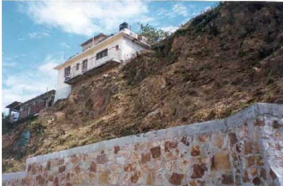
Fotografías Nos. 43 y 44.- Caída de rocas asociado a la fragilidad de las mismas y a asentamientos humanos en las orillas de los escarpes de trazos urbanos.
