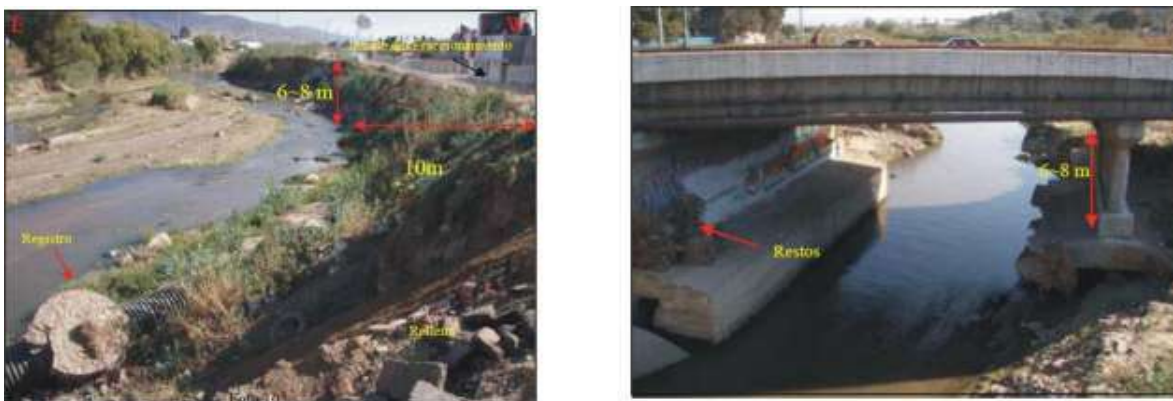
Figura 5.3.9. Imágenes que muestran los cambios al curso del río y daños a los puentes como resultado de las avenidas extraordinarias de septiembre de 2010.
