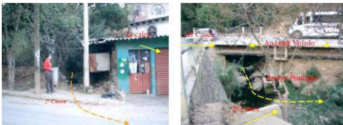
Figura 5.3.15. La imagen de la izquierda muestra un cauce invadido por una vivienda, la de la derecha parte de la infraestructura construida.
