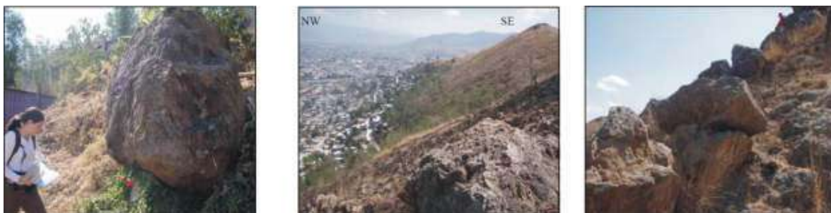
Figura 5.3.7. Imágenes que muestran las condiciones de los bloques susceptibles de rodamiento en la agencia San Juan Chapultepec.
