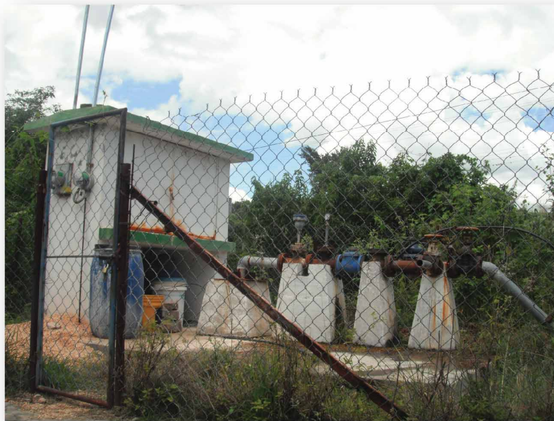
Figura 15.- Equipo de bombeo
