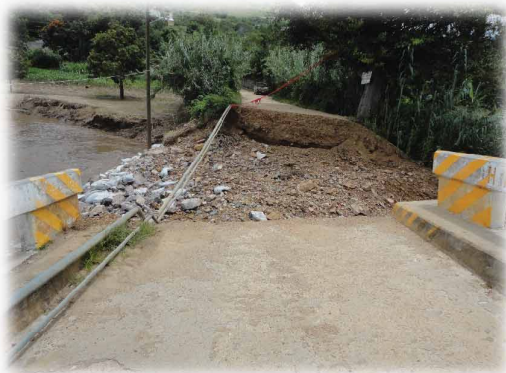
Figura 18.-Puente Morelos dañado
