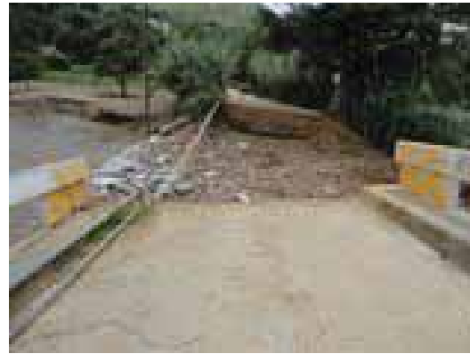
Figura 8.- Colapso del puente
