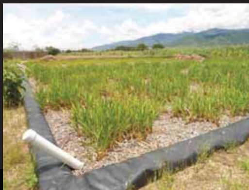
TRATAMIENTO DE AGUAS NEGRAS (PLANTAS HIDROFILAS)
