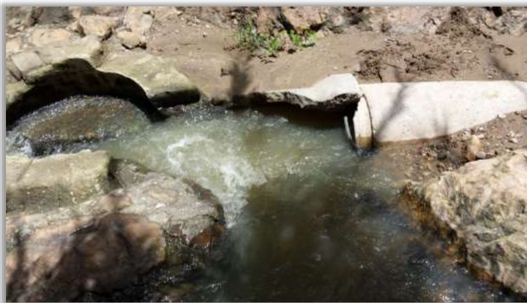
Foto 5. Sistema de aguas negras colapsado
