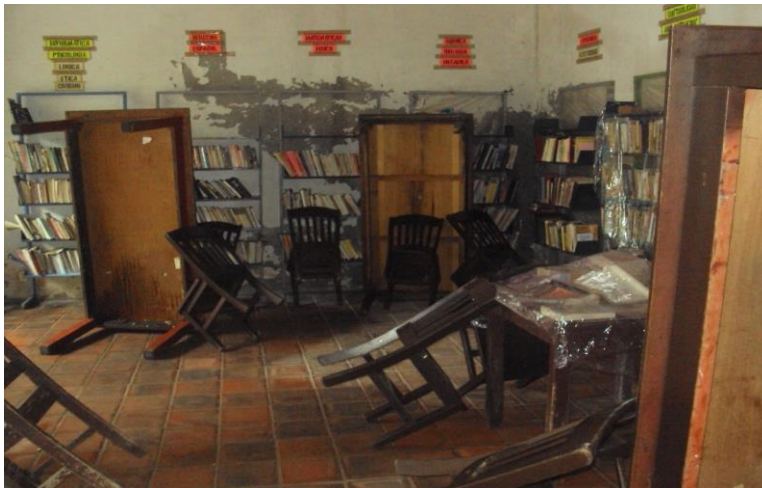
Foto 15. Biblioteca en masl estado
