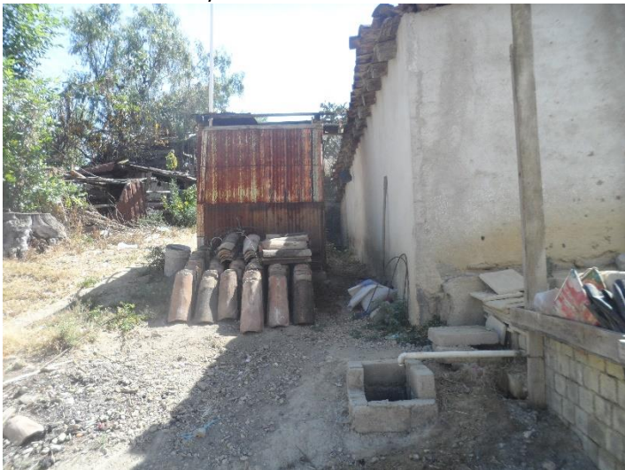
Foto 31. La mayoría de la población cuenta con baños de lámina y en malas condiciones
