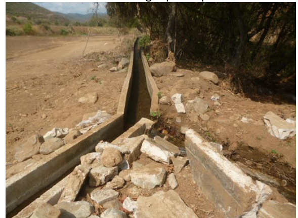
Foto 37. Infraestructura de riego que requiere mantenimiento
