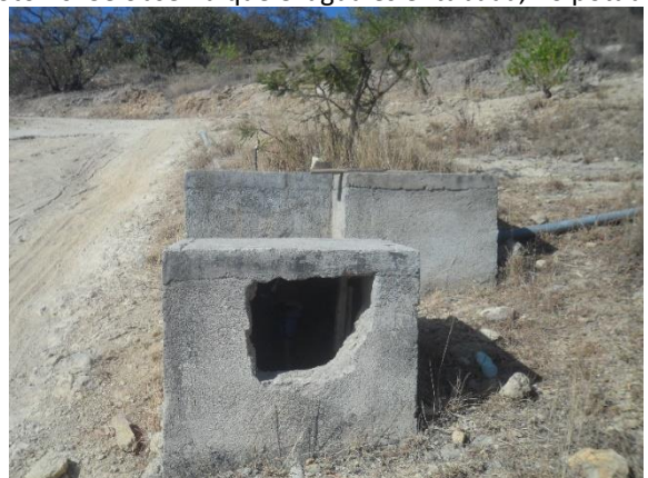
Foto 26. Se observa que el agua es entubada, no potable.
