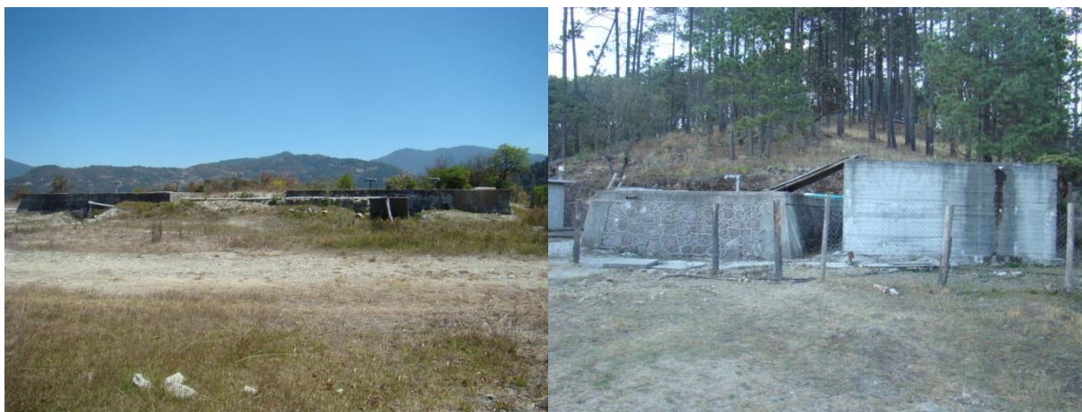
Figura 298. Tanques de almacenamiento de agua
