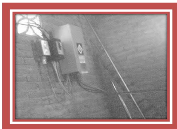
FOTO No. 16 BOMBA LOCAL DE AGUA
