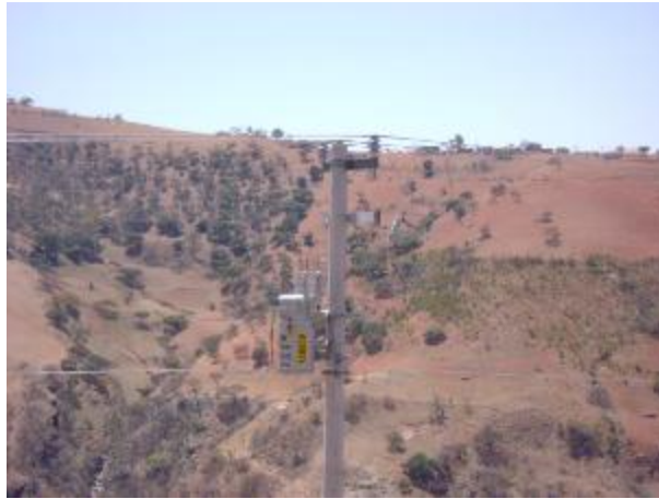
Figura 9. Infraestructura de energía eléctrica
