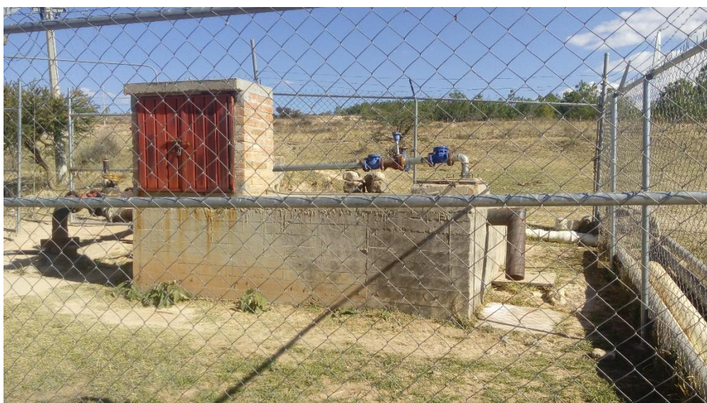
Imagen 14 Infraestructura del Pozo 47 en Magdalena Zahuatlán
