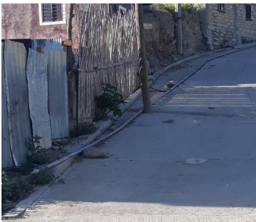
Calle San Francisco ya pavimentada donde se observa que: el tubo de la red de agua potable se encuentra encima del concreto, un poste se encuentra en el interior de la calle, y que la calle no cuenta con banquetas.
