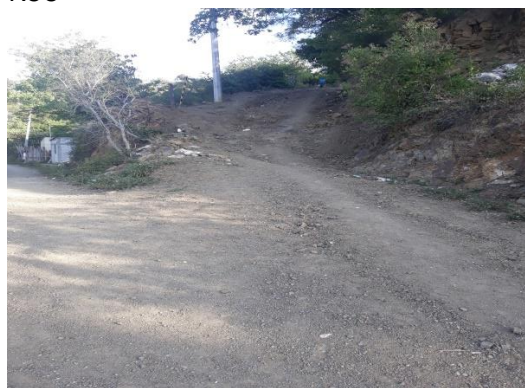
Calle Libertad, Colonia Santa Cecilia en mal estado
