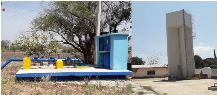
Ilustración 6. Tomas de agua de San Dionisio Ocotlán.
