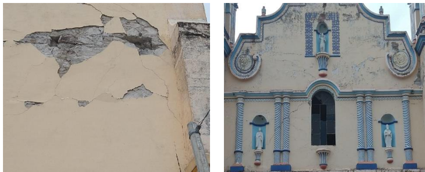
Afectación de la iglesia católica
