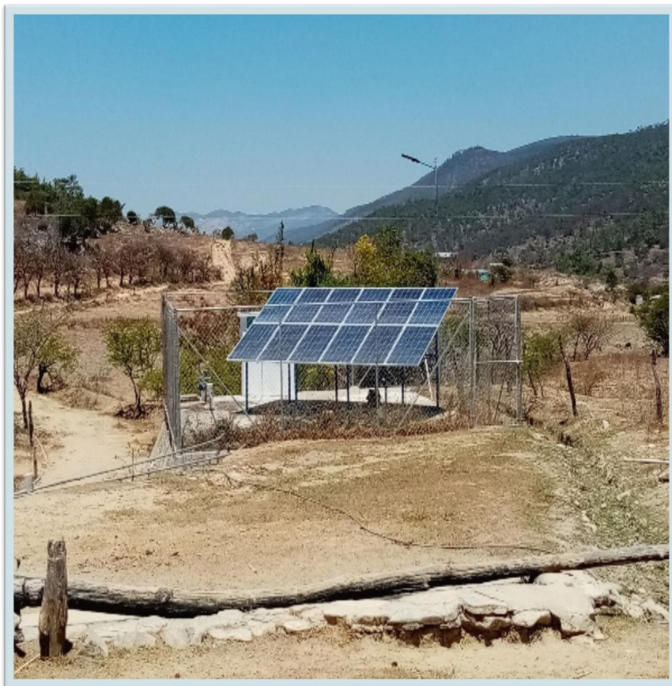
Ilustración 10. Instalaciones de la planta de bombeo en la agencia Guadalupe Victoria
