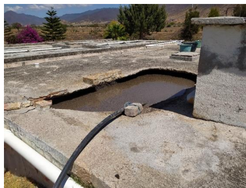
Figura 5. Losa del reactor anaerobio en malas condiciones
