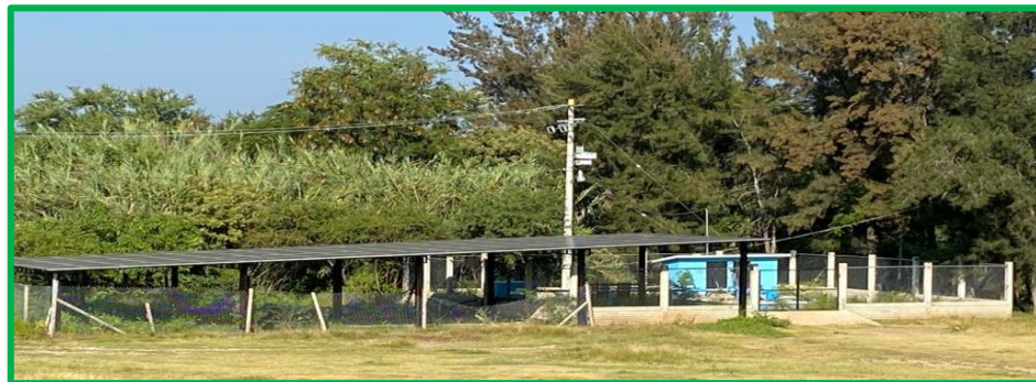
Ilustración 7. Pozo de agua potable.
