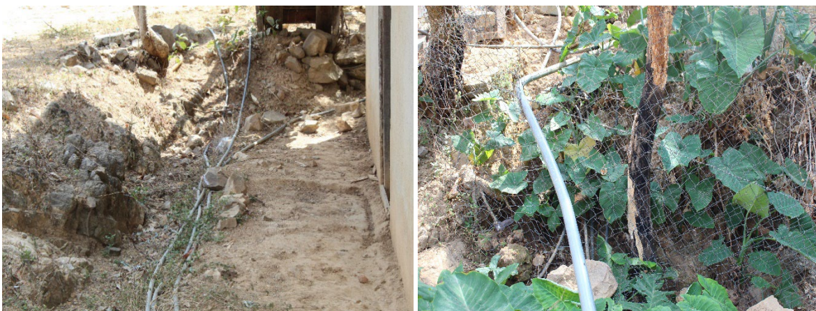
Figura 21 Sistema de Agua Potable en las Viviendas
