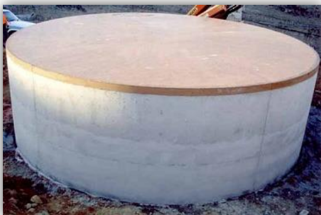
Foto 55. Tanque de almacenamiento de agua
