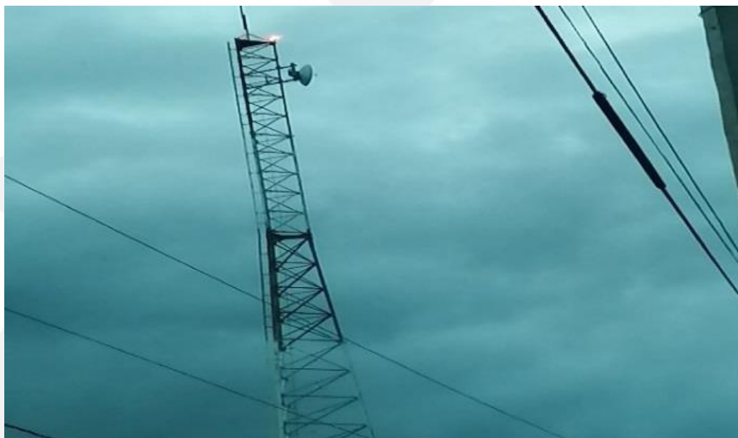
ANTENA DE TELMEX
