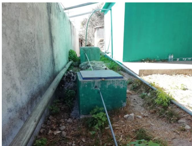
Imagen V. 2. Infraestructura del sistema de agua entubada.
