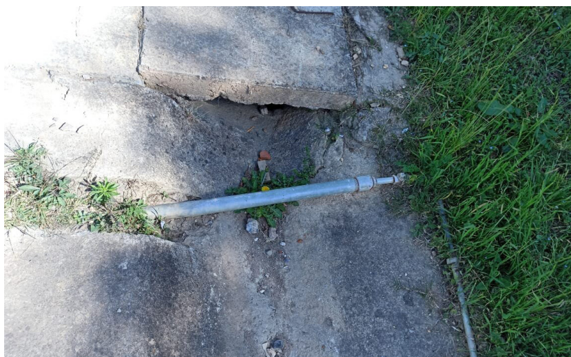
Imagen 16 Tubería de red de agua potable obstruida por pavimento
