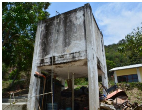
Foto 1; tanque en malas condiciones
