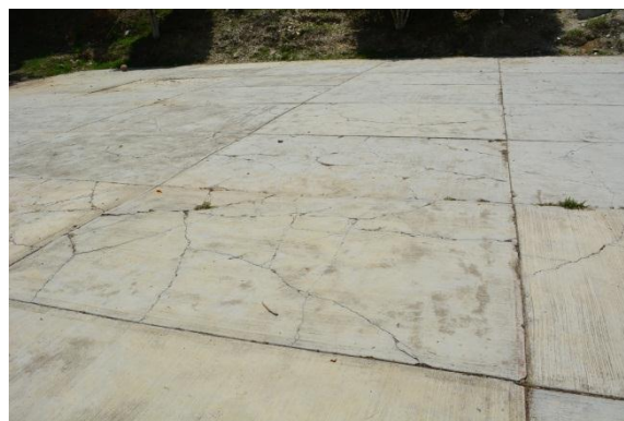
Foto 2: cancha de la secundaria en malas condiciones.
