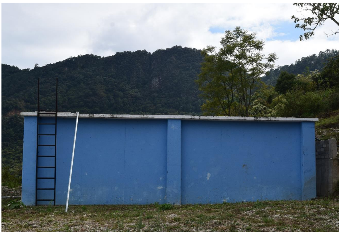
Ilustración 14. Segundo tanque de almacenamiento de agua
