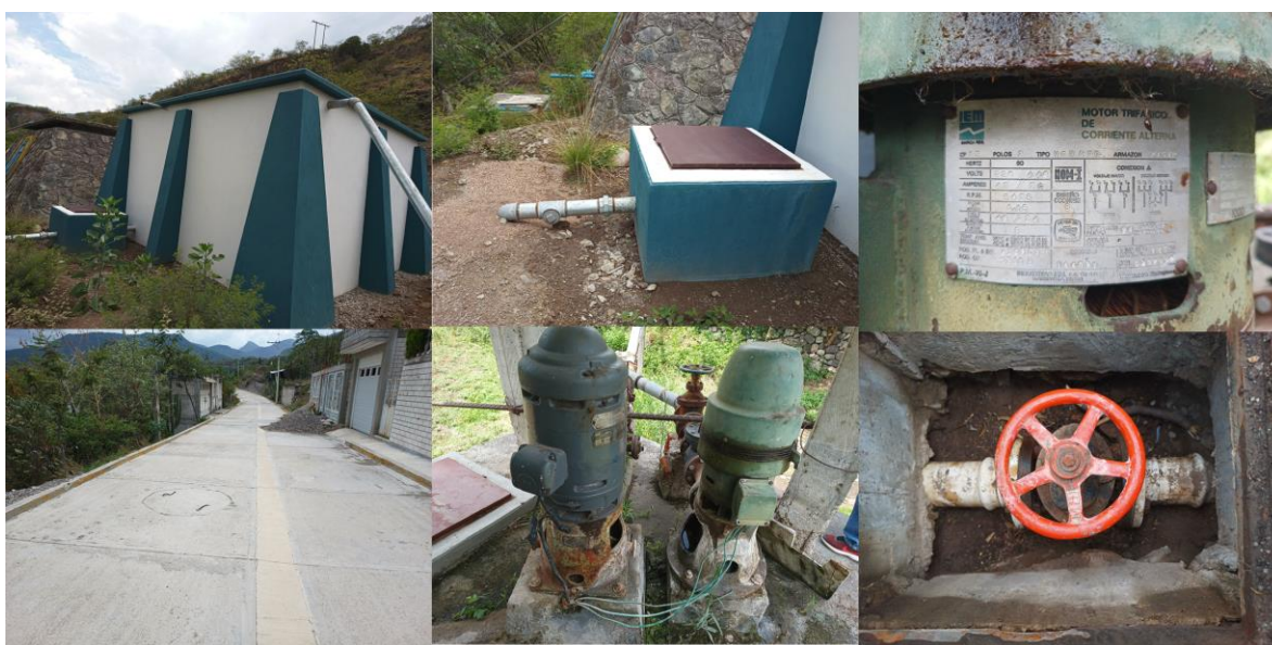
Imagen 14. Sistema de agua potable actual.
