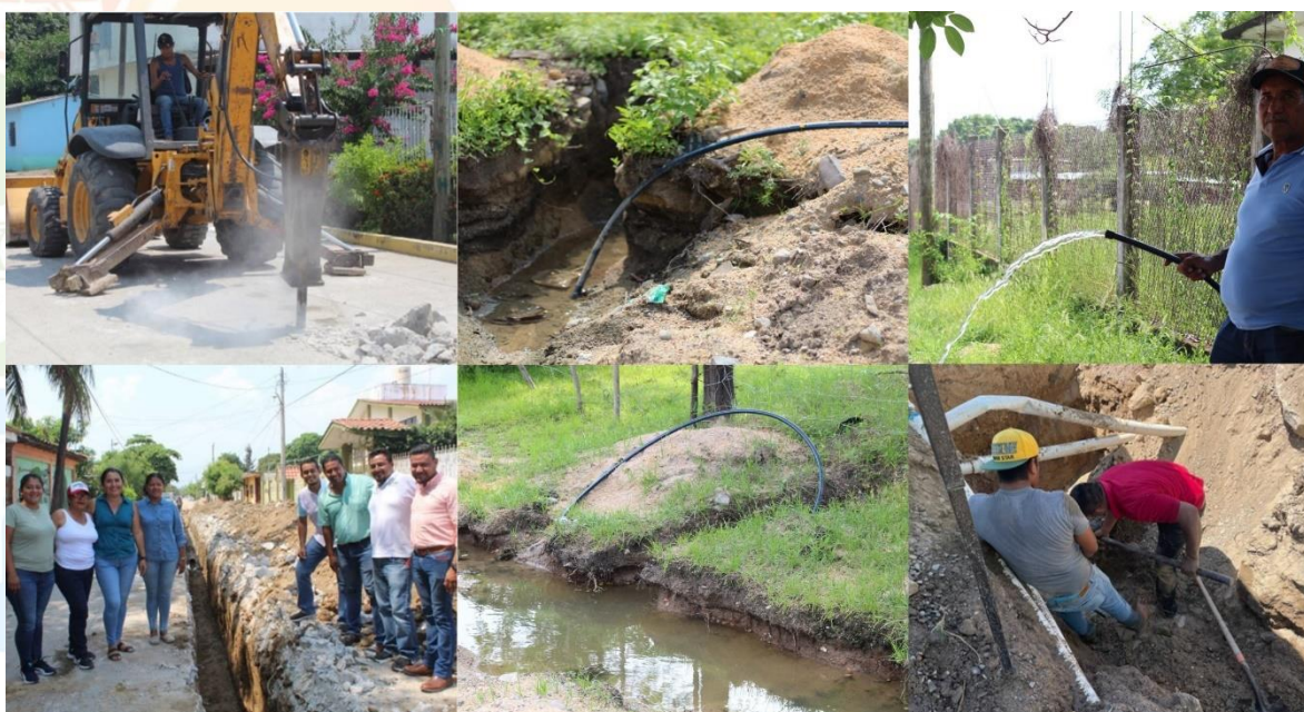
IMAGEN 15. INFRAESTRUCTURA DE AGUA Y SANEAMIENTO, CHAHUITES.
