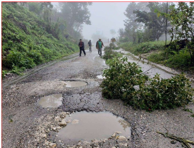
Imagen 19. Caminos rurales y estatales en mal estado.
