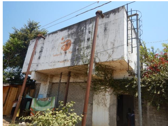
Fotografía 12. Tanque elevado en Colonia Campo de Aviación
