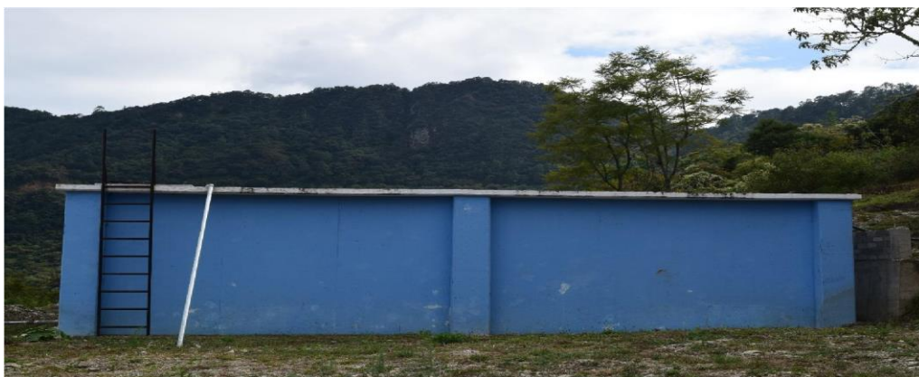
Fotografía 7. Tanque de almacenamiento de agua construido en el municipio.
