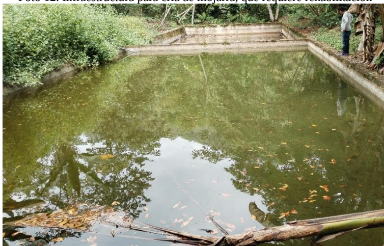
Foto 12. Infraestructura para cría de mojarra, que requiere rehabilitación
