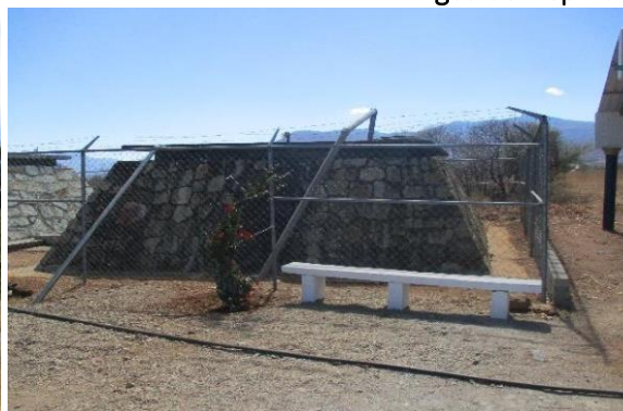
Fotografía 6. Tanque de regulación Agencia Agua del Espino
