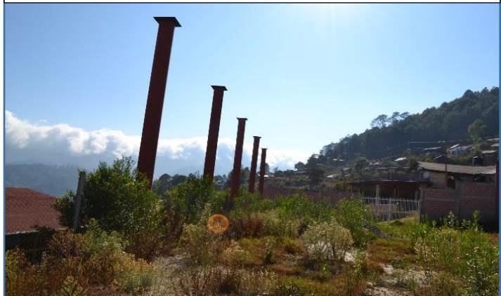
Foto No. 64 Techado inconcluso de la Escuela Secundaria “Maximiliano Ruíz Castañeda”
