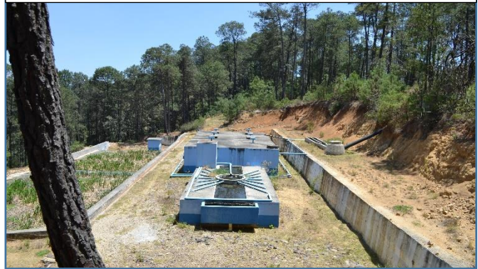
Foto No. 39 Planta de tratamiento de aguas residuales
