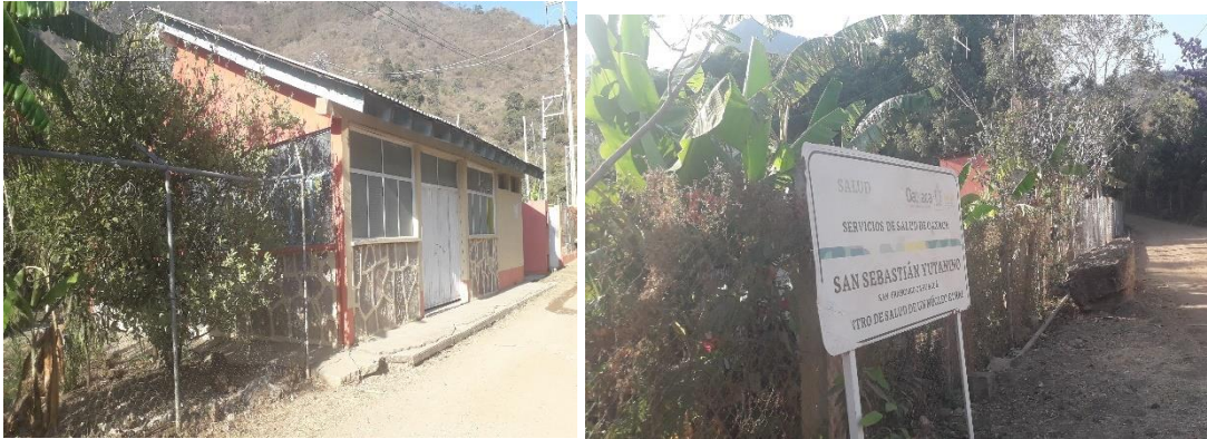
Figura 2. Falta de cercado perimetral en el Centro de Salud San Sebastián Yutanino
