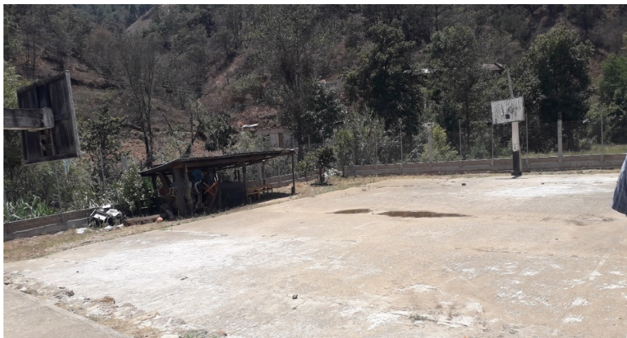
Figura 37. Falta de mantenimiento y construcción del techado en la primaria
