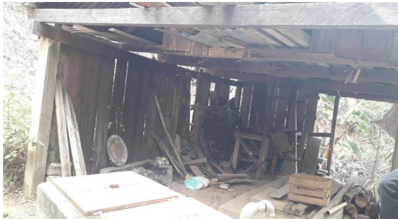
Figura 42. Espacio de cocina comunitaria en el preescolar en malas condiciones.
