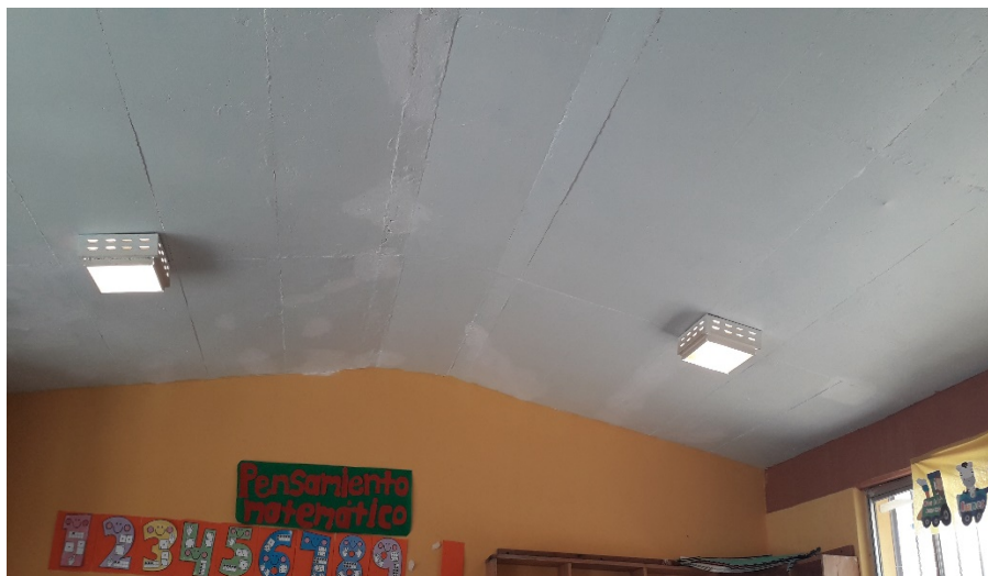
Figura 22. Techo con problemas de filtración en el preescolar
