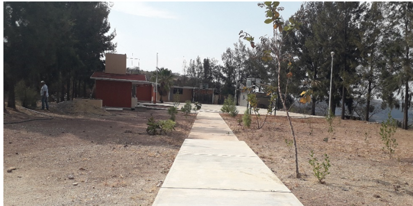
Figura 33. Falta de la barda perimetral en la telesecundaria
