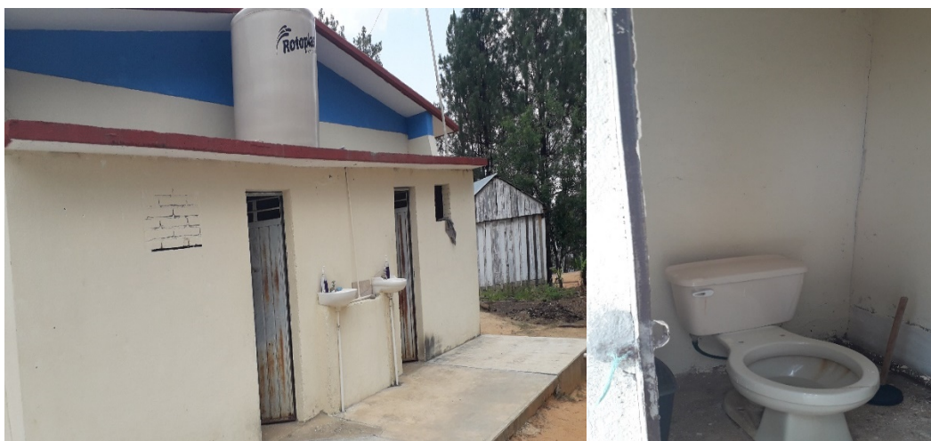
Figura 46. Falta de mantenimiento de sanitarios en la telesecundaria
