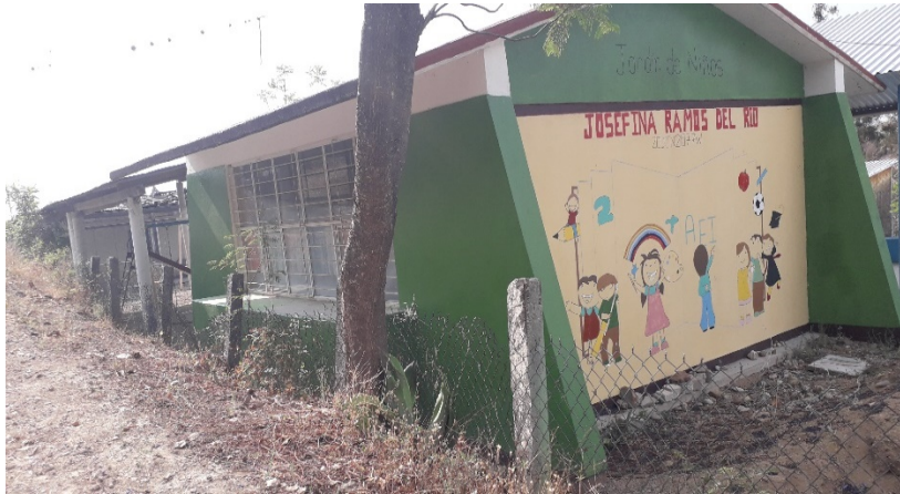
Figura 29. Falta de barda perimetral en el preescolar
