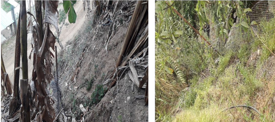
Figura 44. Área perimetral de la primaria en riesgo por derrumbe
