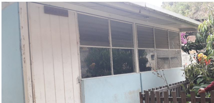
Figura 43. Falta de remodelación y protección de las ventanas en la primaria
