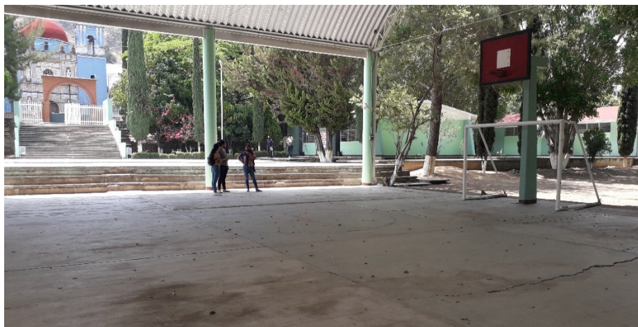
Figura 28. Construcción de la cancha que se encuentra deteriorada en la Secundaria General.
