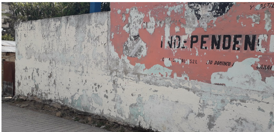
Figura 31. Muro de la entrada de la escuela primaria en malas condiciones
