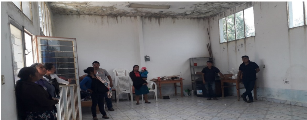
Figura 10. El techo deteriorada y filtración de agua en la casa de salud en Extebé.
