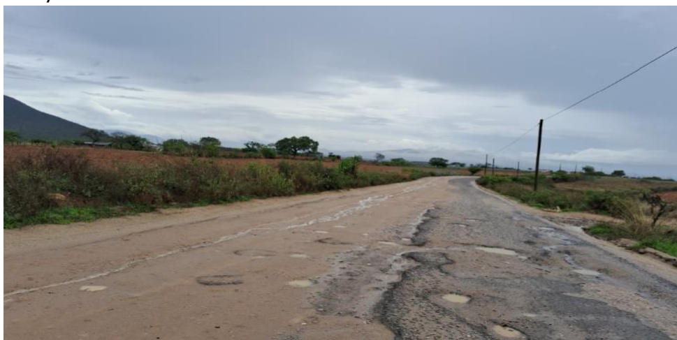
Carretera en mal estado que conduce a San José del Peñasco
