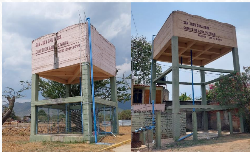
FIGURA 34 TANQUES DE AGUA POTABLE DE SAN JUAN CHILATECA
