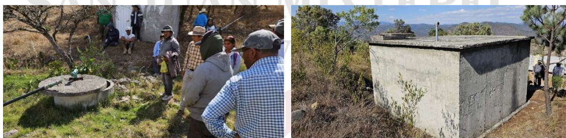
Ilustración 10 Pozo y tanque de distribución existente en la localidad de San Pedro Yososcua.
