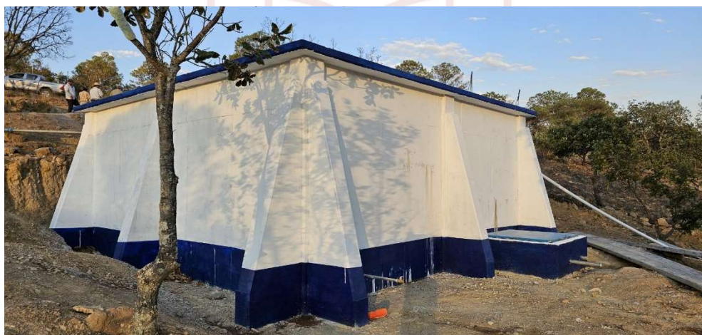
Ilustración 13 Tanque de distribución de agua entubada en la localidad de Arroyo del Sabino.
