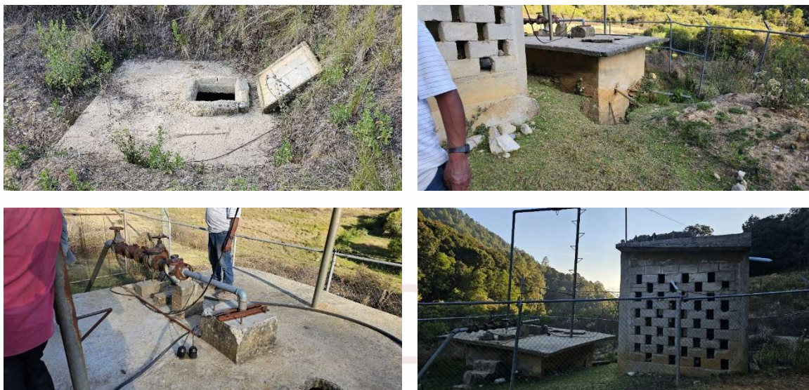
Ilustración 9 Infraestructura de agua entubada existente en la localidad de Los Tejocotes.
