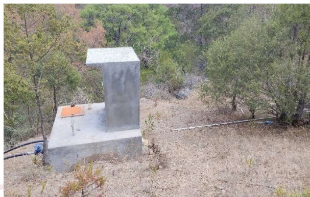
Ilustración 12 Tanque de captación existente en la localidad de Río Timbre.
