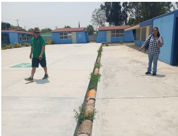
ILUSTRACIÓN 38.- DESAGÜE PLUVIAL DE LA EXPLANADA CÍVICA DE LA ESCUELA PRIMARIA.
