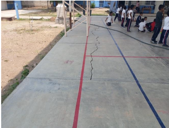
ILUSTRACIÓN 37.- AGRIETAMIENTO DE LA CANCHA DE BÁSQUET BOL DE LA ESCUELA PRIMARIA.
