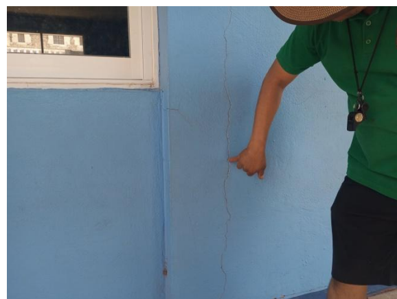
ILUSTRACIÓN 36.- INFRAESTRUCTURA CON DAÑO ESTRUCTURAL EN LA ESCUELA PRIMARIA DE SAN JUAN TEITIPAC.
