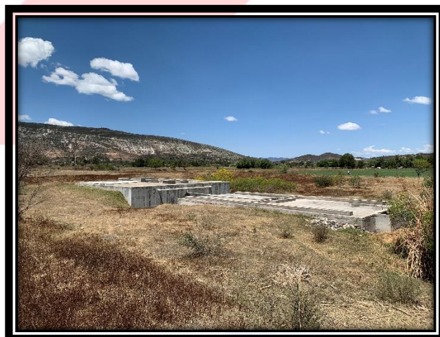
Foto. Planta de tratamiento
