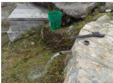
Imagen 26: Salida de agua del tanque de agua de San Pedro Coxcaltepec Cántaros.
