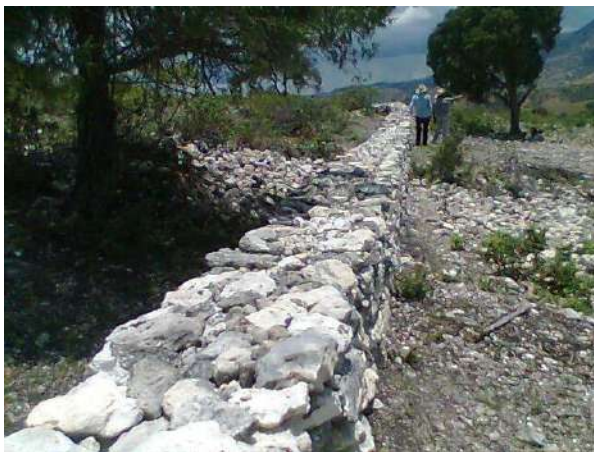
Imagen 14: Muro de retención para evitar deslaves.
