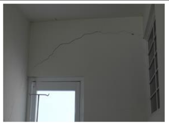
Daños en la Casa de Salud, por el sismo de 2017
