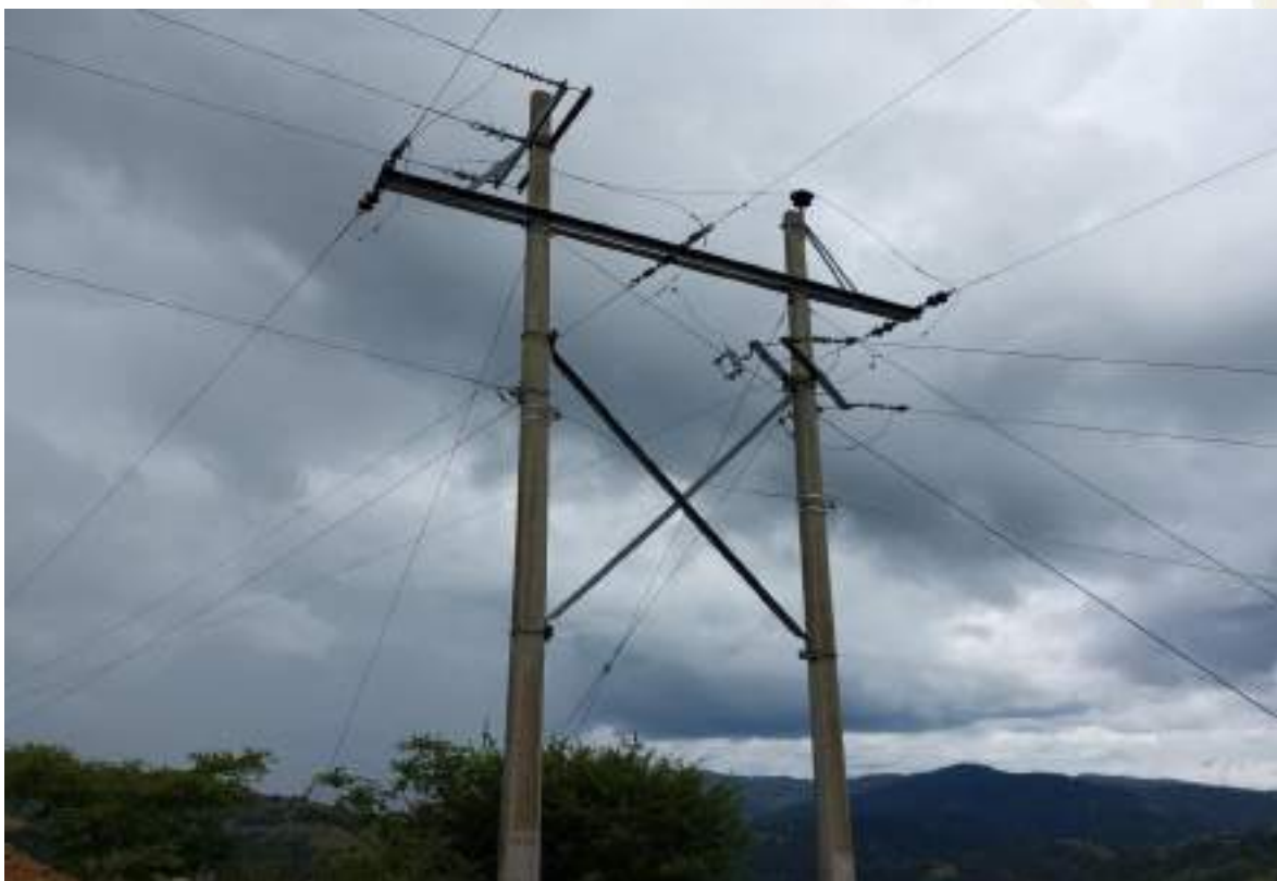
Fotografía N° 75 Cableado en postes de luz en los alrededores de Tepelmeme Villa de Morelos. Fuente: Autoría propia.
