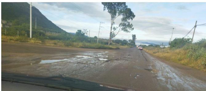
Ilustración 27 Fotografía de la carretera en mal estado que se dirige del municipio de Tlacolula de Matamoros a municipio de Villa Diaz Ordaz
