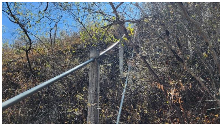
Línea de conducción del municipio de San Miguel del Río
