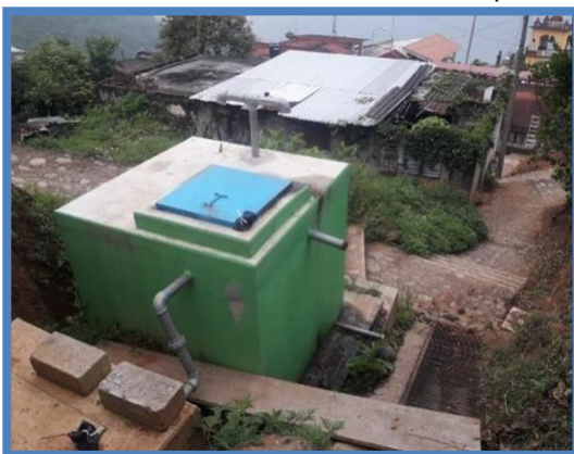
Imagen 24. Registro de agua potable que abastece a las viviendas del municipio.
