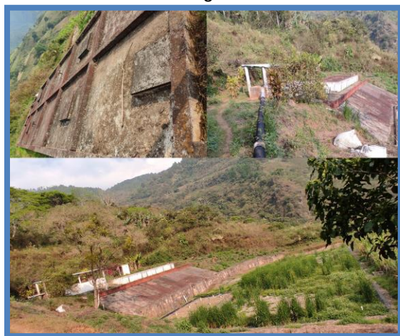
Imagen 26. Condiciones de la planta de tratamiento de aguas residuales.
