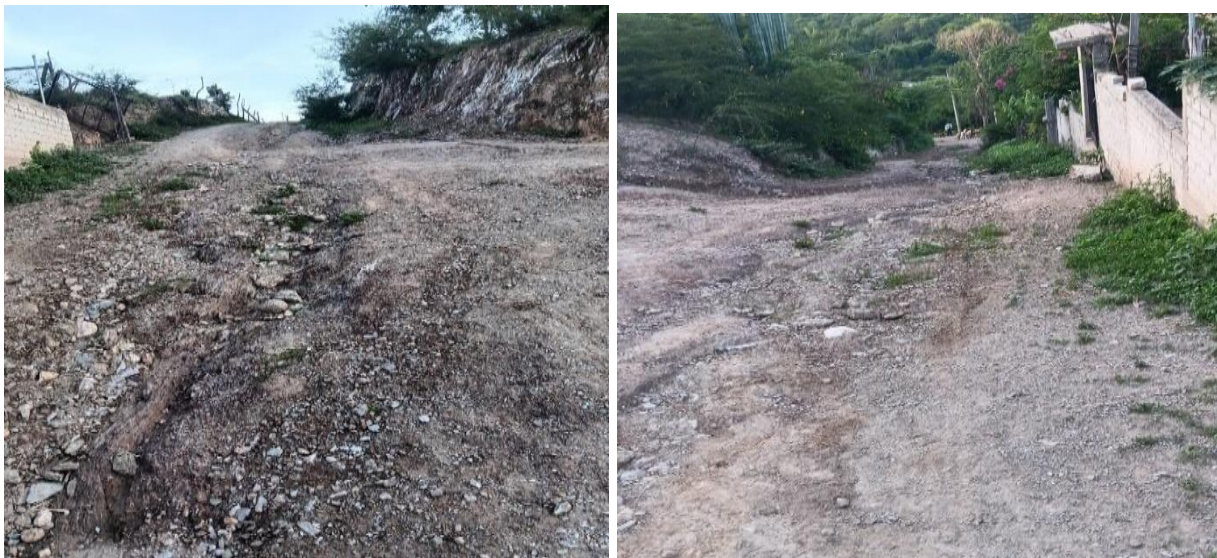
Figura 10: Calle en malas condiciones físicas, Fresnillo de Trujano
