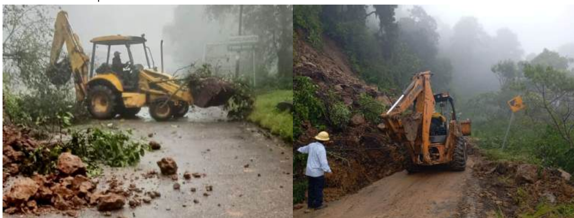
Muestra de intervenciones en tramos carreteros debido a deslaves de los cerros aledaños.
