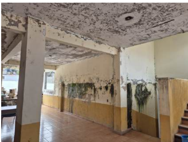
Muestra de las condiciones estructurales del edificio donde se encuentra el INEA.
