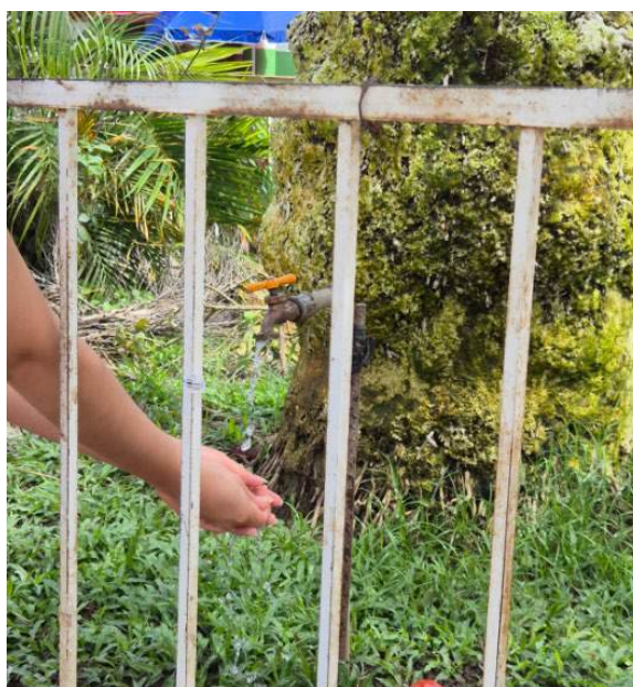
Llave pública de agua potable ubicada en el parque central municipal de Putla Villa de Guerrero
